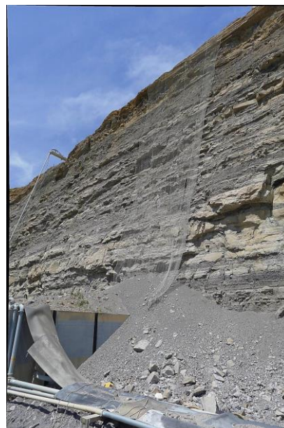
Figura 3. Immagine della parete di roccia e della rete metallica di contenimento per caduta massi
