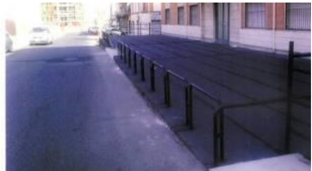
Figura 8. Marciapiede-terrazza oggetto della controversia
